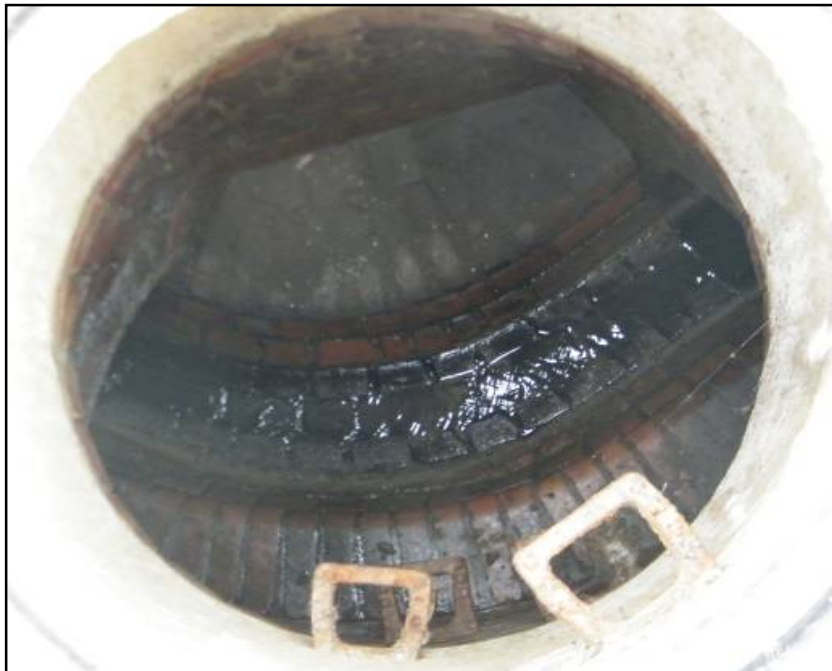
Geringer Abfluss [Velbert, 2014]
