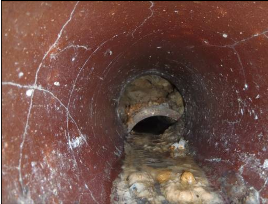
Versackung/ Muffenversatz [Backnang, 2014]
