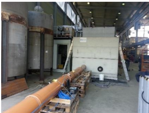
a) Ablauf-Rohrleitung aus dem Drosselbauwerk
