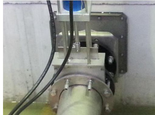
b) Detailansicht: Herunter gefahrener Schieber
