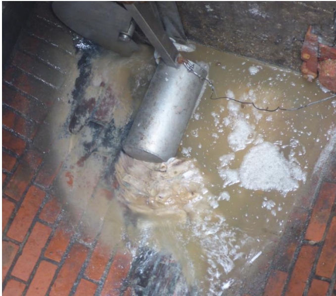
Bild 3 Beispiel für eine Verlegung des Drosselorgan-Schwimmers mit Beeinträchtigung seiner Funktion
