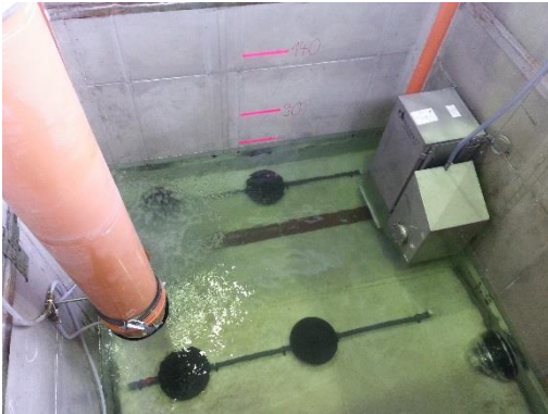
a) Drossel bei einem Wasserstand von 0,6 m
