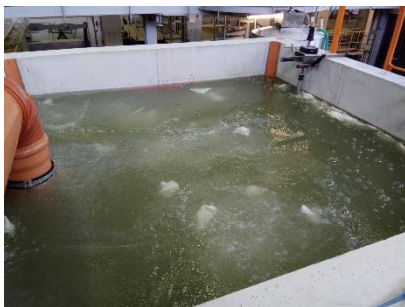
a) Voll eingestautes Regenbecken
