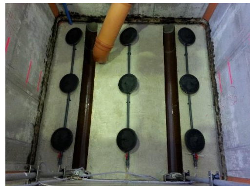
b) Gereinigtes Becken
