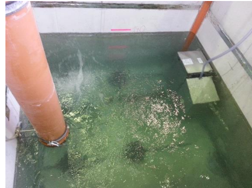
b) Drossel bei einem Wasserstand von 1,4 m
