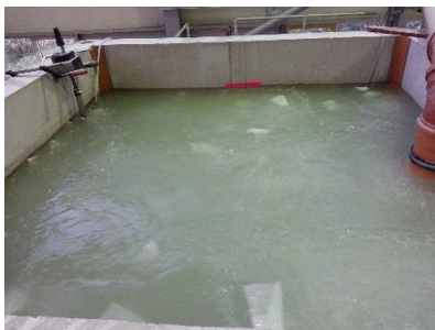
a) Voll eingestautes Regenbecken
