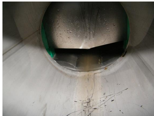
b) Kratzspuren am Schieberblech S2 durch Düsenanprall
