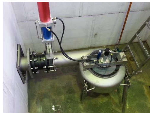
d) Eingebautes Drosselorgan
