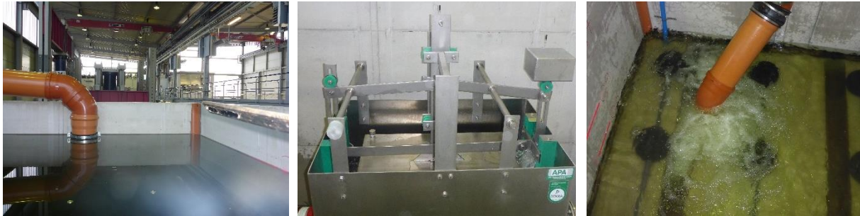
a) Voll eingestautes Regenbecken b) Drossel in Betrieb (SüwVO I) c) Wieder-Befüllen des Beckens Bild 19 Einstau im Regenbecken und Betrieb der Drossel
