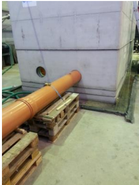
a) Ablaufleitung (v. außen)
