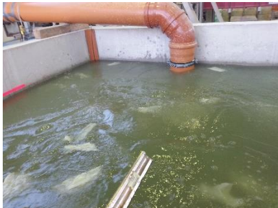
a) Voll eingestautes Regenbecken
