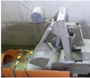
a) Drossel im Betrieb
